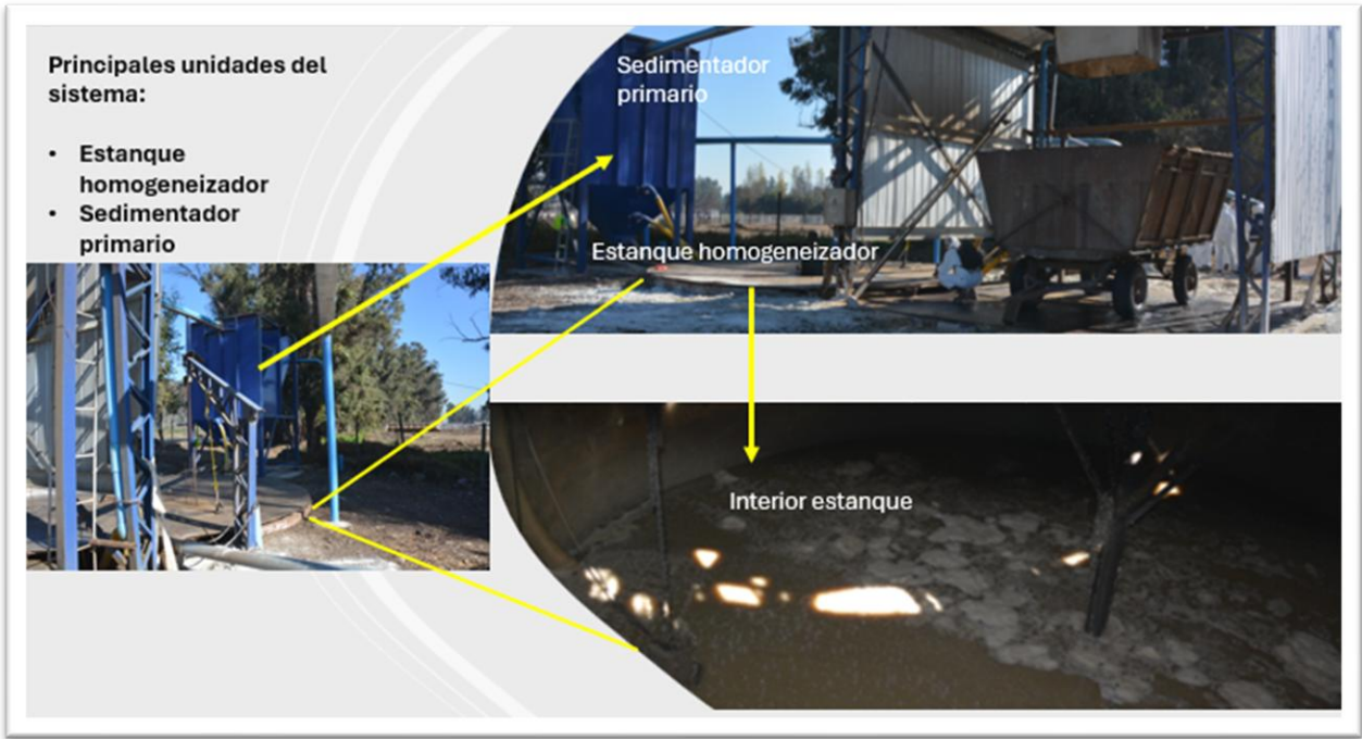
Figura N° 22. Principales unidades del sistema de tratamiento (planta de guano)
