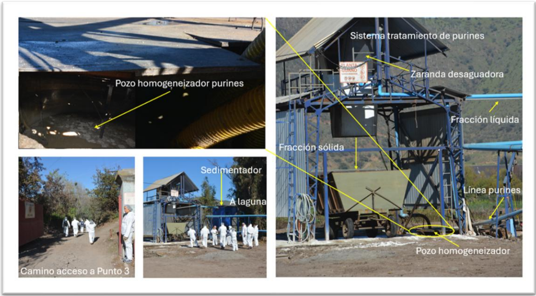
Figura N° 20: Sistema de tratamiento purines
