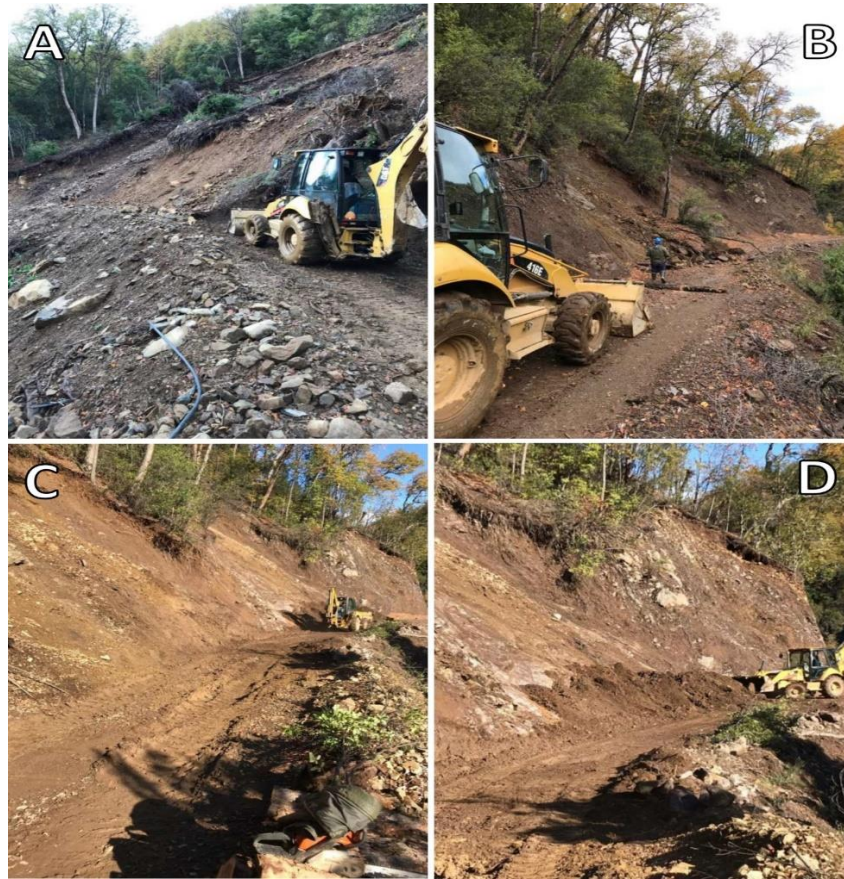
Figura 11. Pérdida de vegetación en laderas por deslizamientos y derrumbes.
