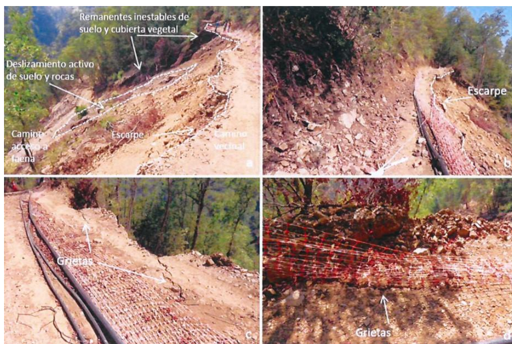
Figura N° 13: Escarpe de remoción en masa que afectó camino vecinal (Informe Sernageomin INF-02-MAULE-2019).
