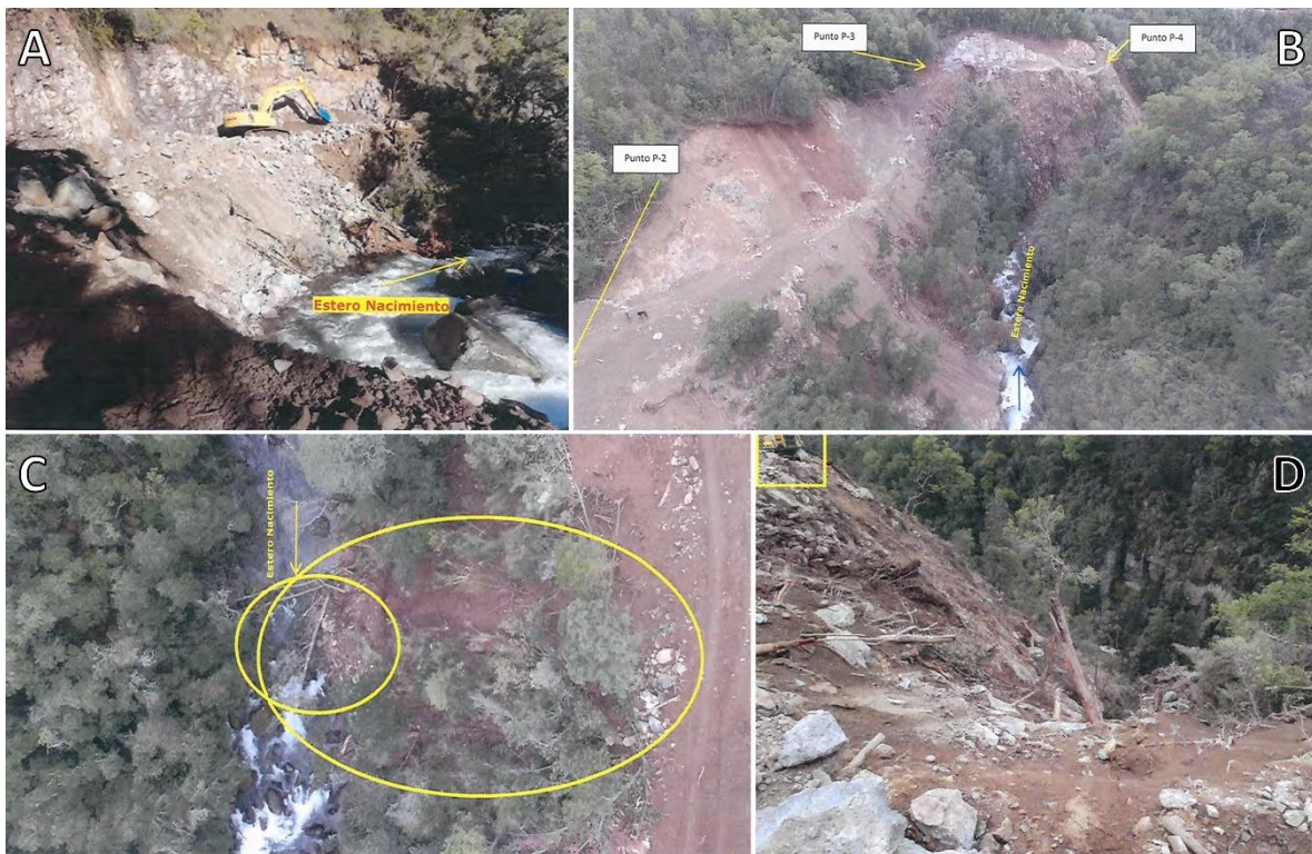
Figura N°10: Afectaciones al estero Nacimiento.
